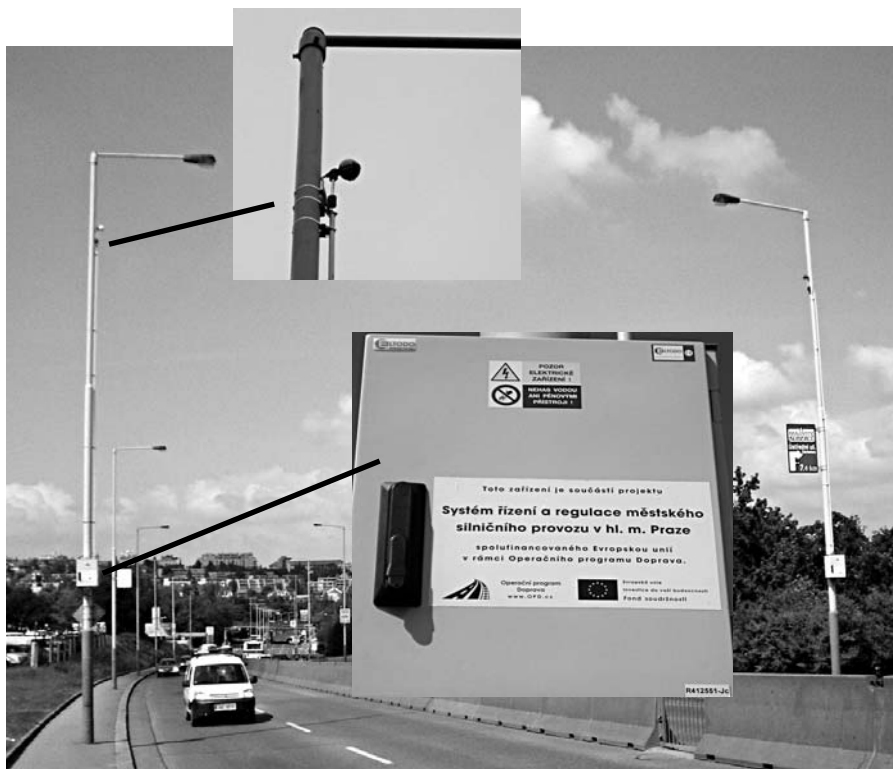
Obr. 3: Typická instalace SD řezového, detail kamery a rozvaděče, ul. Vídeňská, Praha 4
